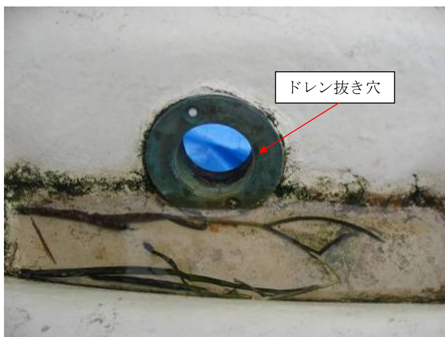
写真8 ドレン抜き穴（左舷側）の状況
